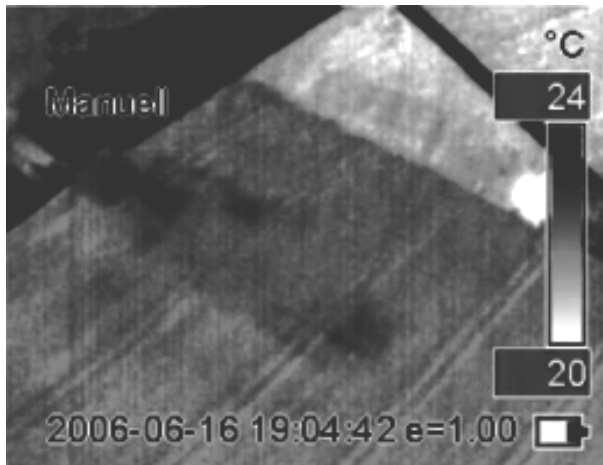
Abb. 11a/b Wärmebilder der Villa
